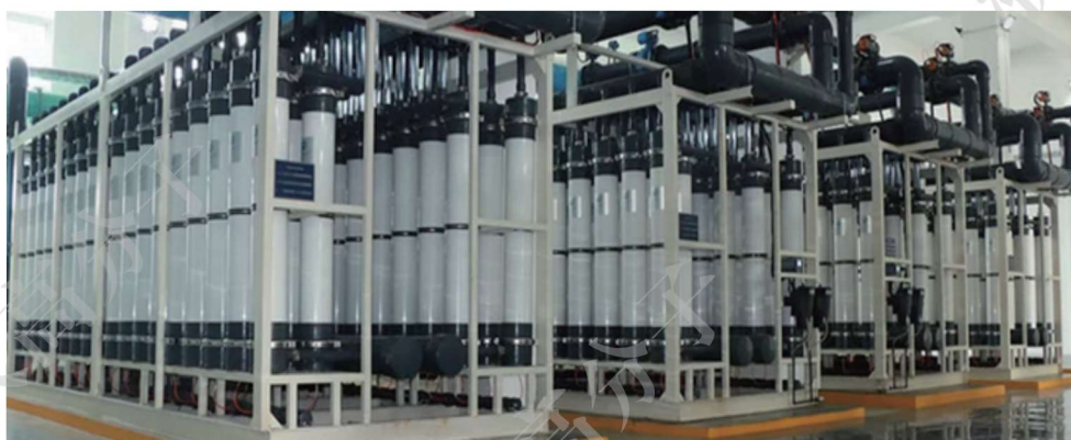
高性能中空纤维超滤膜水处理工程
